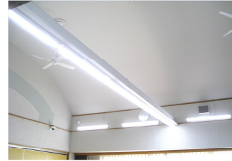
全施設、照明 LED 化・省エネエアコン化。 ＝ 尾山台ナザレン幼稚園 ＝
